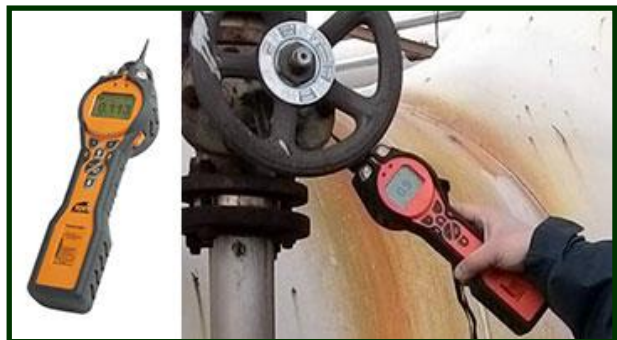
Monitoraggio Emissioni fuggitive con PID
